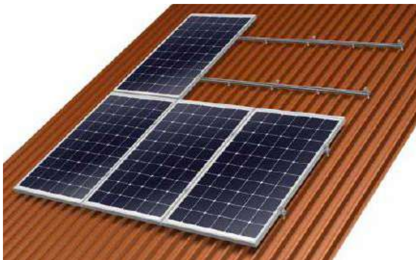
Slika 2. Primjer montiranih fotonaponskih panela na sustav nosača
